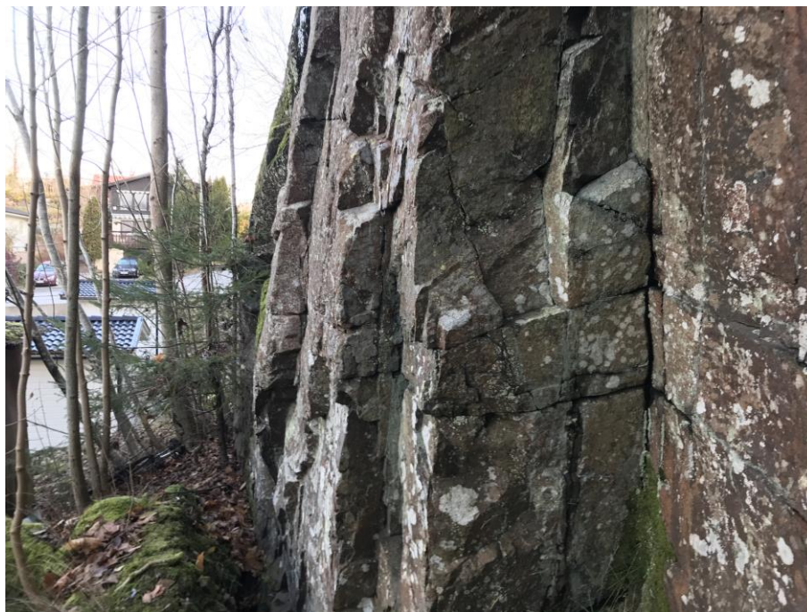
Figur 3.2. Sprickgrupp 2 bildar brantstående släntparallella skivor. Bild tagen mot norr från baksidan av det demolerade skjulet söder om befintligt bostadshus.
