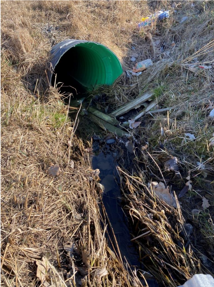
Figur 8. Bild på diket längs med Ljungskilevägen. Som framgår av bilden är det en del växtlighet och skräp i diket. Bilden togs under platsbesök 2022-03-23.
